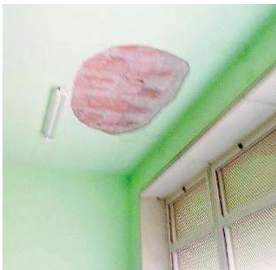
Una porzione di soffitto della materna ha ceduto
