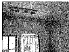
Particolare impianto illuminazione
